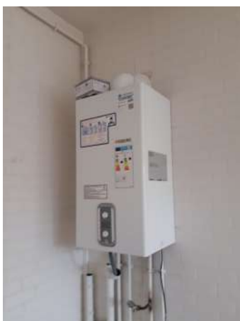
Chaudière gaz individuelle © RBBD
