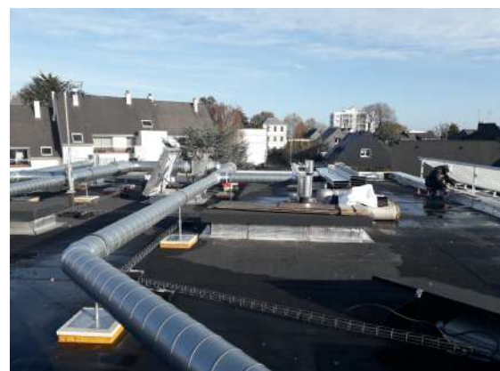
Réseau de ventilation en toiture © cohérence
